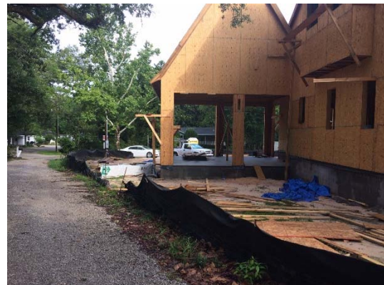
Carport/garage encroachment on setback line
